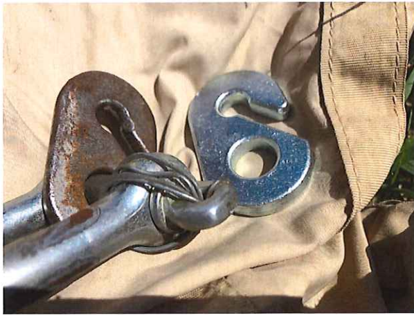
TOSTプラグコネクション新品(右側)と摩耗した物(左側)
